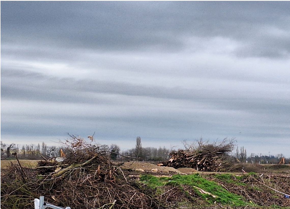
Opérations de défrichage réalisées par Spie Batignolles, attributaire du lot 2 de la phase 1. Ces travaux préparent le terrain en vue des futurs aménagements paysagers et de la renaturation des berges
